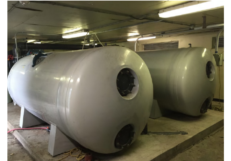
Intérieur de la station d'épuration, Jonathan Cha, 2016.
