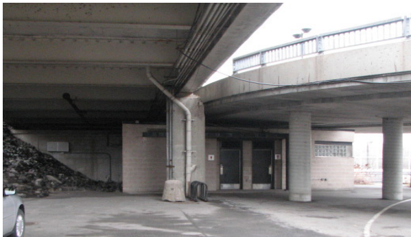
SOUS-STATION ÉLECTRIQUE VESP. PONT DES ILES | date: 1966
