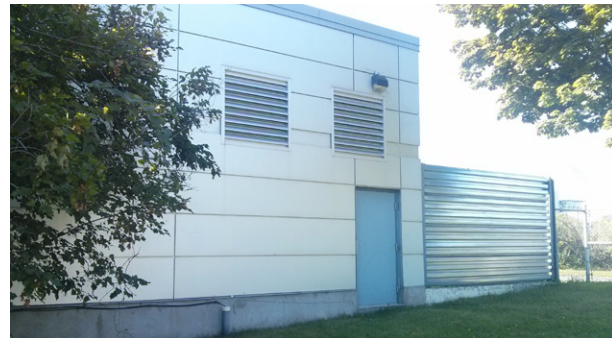
SOUS-STATION ÉLECTRIQUE | date: 1966
